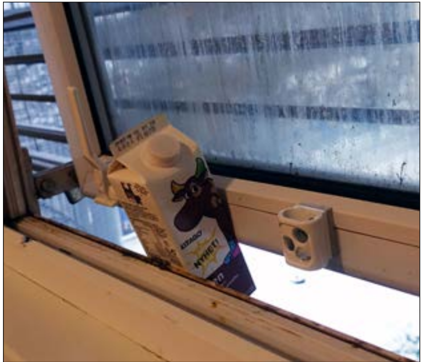
Vinduet fra dette pasientrommet var, i likhet med andre vinduer, vanskelig å se igjennom på grunn av dårlig renhold. (Foto: Ukom)
