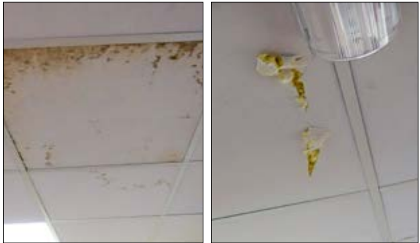
Takplatene i skjermingsenheten hadde søl og skader. (Foto: Ukom)
